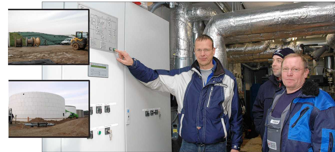
Der Geschäftsführer der Bioenergie Neuhof GmbH, Bernhard Leclaire (l.) nimmt mit dem symbolischen Druck auf den grünen Knopf das Nahwärmenetz in Betrieb. Mit dabei auch Betreiber Florian Kienzle (M) und Anlagenmonteur Reinhard Kutschki. In Silos liegt Mais und Getreide bereit (oberes kl. Foto). Seit gestern werden die Fermenter (unteres kl. Foto) befüllt.
